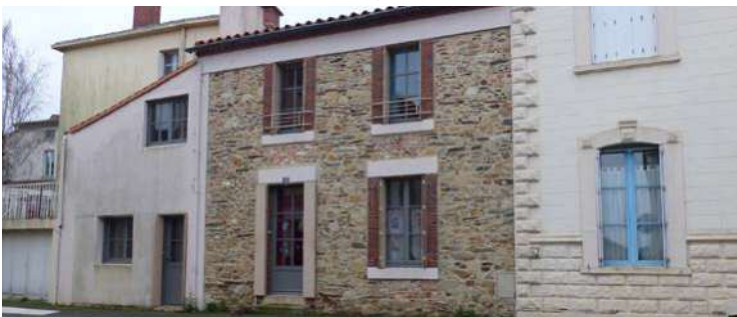
Exemple d'une façade ancienne ayant perdu son enduit
