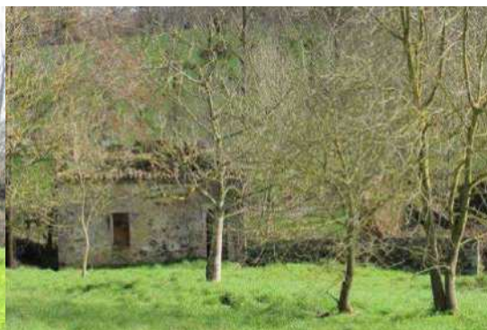
Moulin du Boistissandeau en ruines - 2013 (source : AVAP Les Herbiers - 2014)
