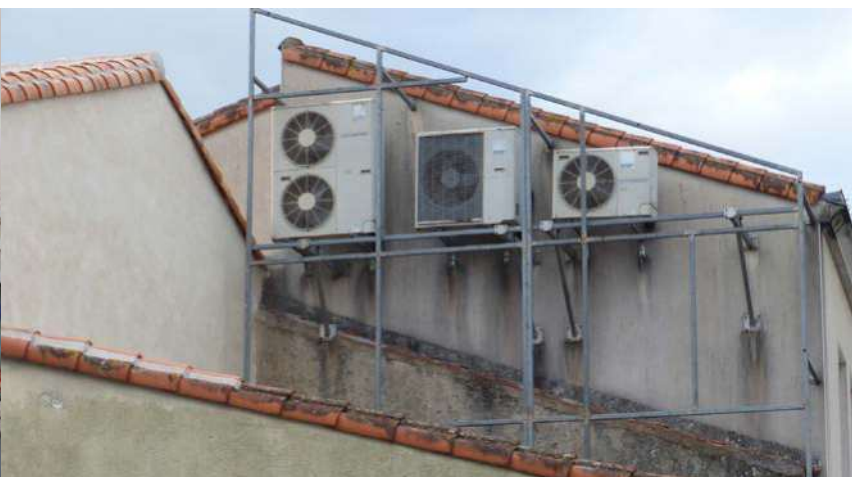
Eléments techniques (pompes à chaleur notamment) visibles en façade
