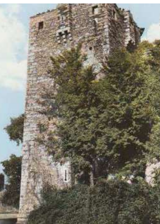
Après 1964 (toiture effondrée) (source : AVAP Les Herbiers - 2014)
