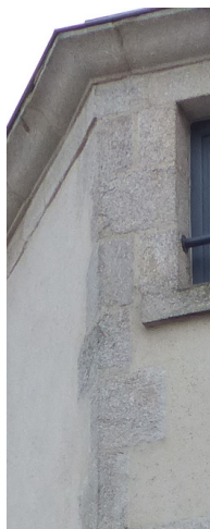
Corniche, et chaînage en pierre de taille (cliché Anne Boissay - architecte)
