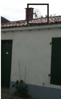
Parabole implantée en toiture, dissimulée par une cheminée
