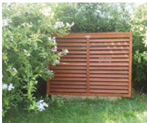
Pompe à chaleur dissimulée derrière un coffre en bois, dans le jardin
