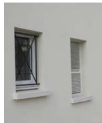
Pompe à chaleur dissimulée derrière une grille dans une baie de la façade
