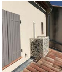
Pompe à chaleur dissimulée derrière un coffre en aluminium sur façade arrière
